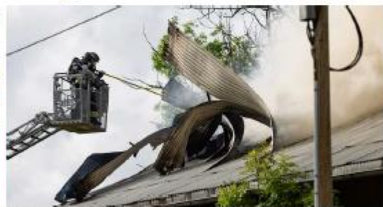
Erschwerend: Die Einsatzkräfte müssen das Blechdach öffnen, um löschen zu können.
