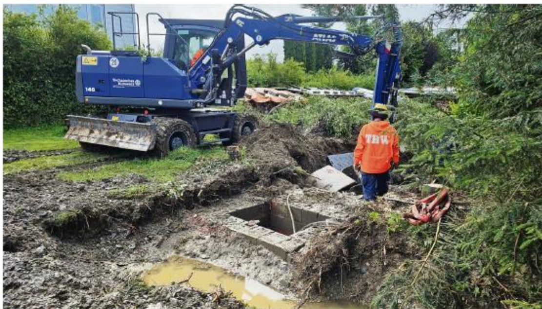
Kameraden des Technischen Hilfswerks (THW) Suhl haben mit einem Bagger nach der schadhaften Stelle im Rohrsystem gesucht und diese freigelegt.
