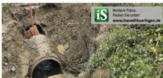
Die schadhaften Rohre müssen raus.
